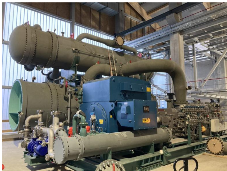
Jedno ze tří tepelných čerpadel vedle čistírny odpadních vod, které již nyní vyrábí klimaticky neutrální teplo pro vídeňské domácnosti
