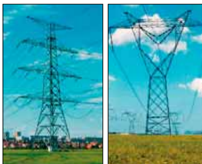
Obr. 2: Soudek (kotevní) – příklad jednoho ze základních typů stožárových konstrukcí vedení ČEPS 400 kV.
