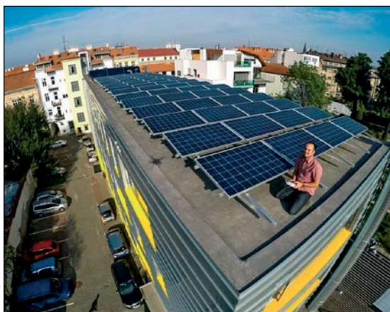
Fotovoltaická elektrárna na střeše budovy B v areálu Otevřené zahrady v Brně
