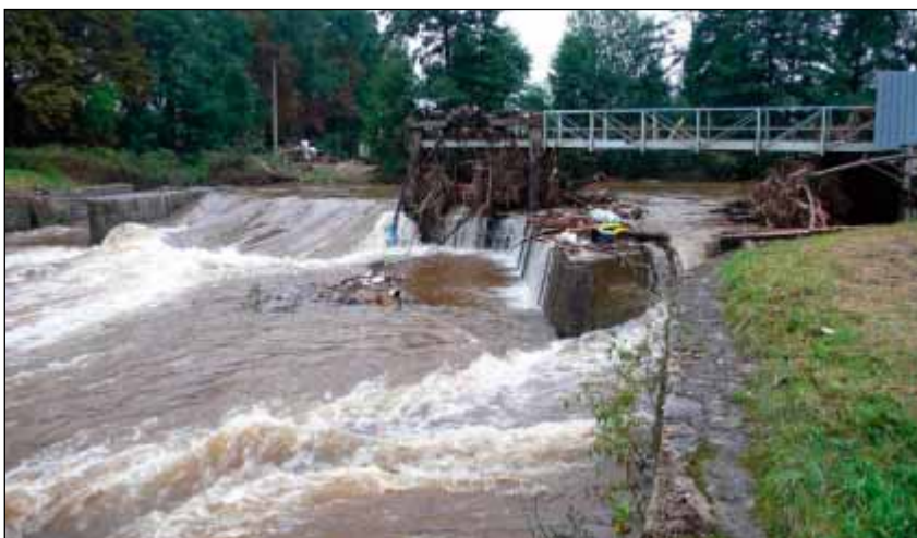
Jez ve Frýdlantu po povodni v roce 2010
