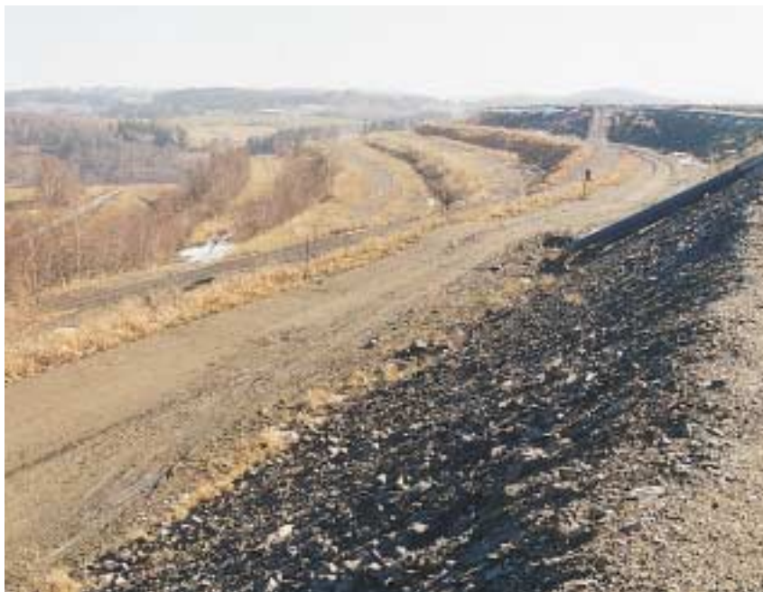
Obr. 2: Vnější stupňovité terasované svahy hráze odkaliště odpadu (K1) z úpravny uranové rudy v Rožné (v pozadí pahorkatinný reliéf Nedvědicke vrchoviny)
