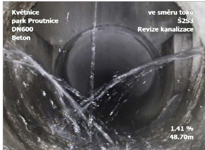
Obr. 21: Balastní vody nepatří do splaškové oddílné i jiné kanalizace (vzniká též riziko kavernózních jevů).
