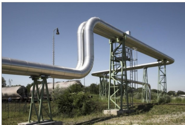
Obr. 36: Potrubí soustavy CZT, příklad nadzemní trasy.
