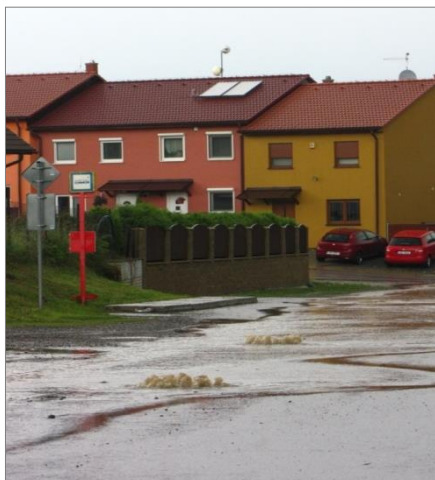
Obr. 20: Při přetížení jednotné kanalizace dochází k hygienickému znehodnocení veřejného prostoru.
