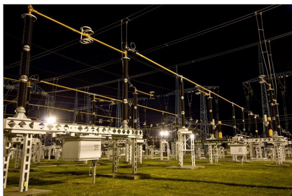
Obr. 33: Rozvodna. Zdroj: ČEPS / www.ceps.cz .
