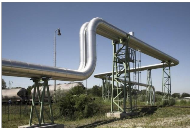
Obr. 36: Potrubí soustavy CZT, příklad nadzemní trasy.
