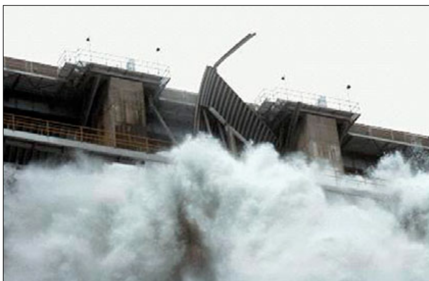
Obr. 2: Porušení hrazeného přelivu na přehradě Folsom (Kalifornie, USA) v roce 1995 [16]
