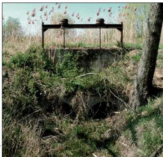
Dochovaný objekt napouštěcího zařízení závlahové soustavy v břehu Bařova kanálu (vzdušná strana) a patrný navazující závlahový příkop
