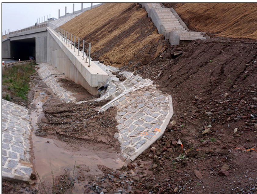
Dopady povrchového odtoku a transportu sedimentu z budovaného náspu [Kavka, 2020]
