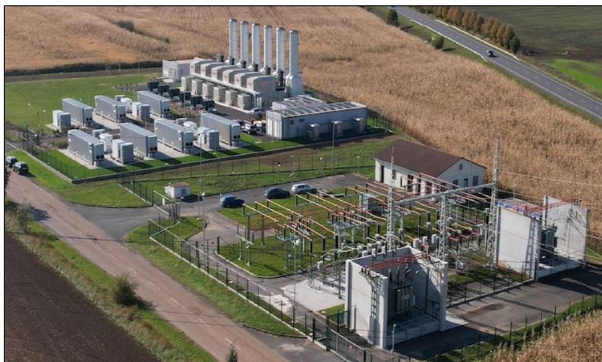
Bateriové úložiště ve Vraňanech
